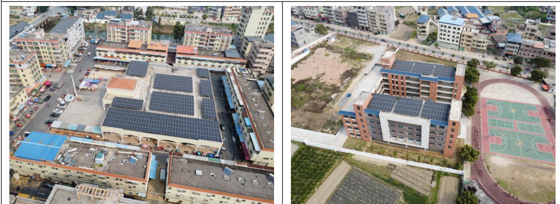
顿岗镇政府宿舍楼、农贸市场及中心小学 527KW 屋面光伏发电项目
