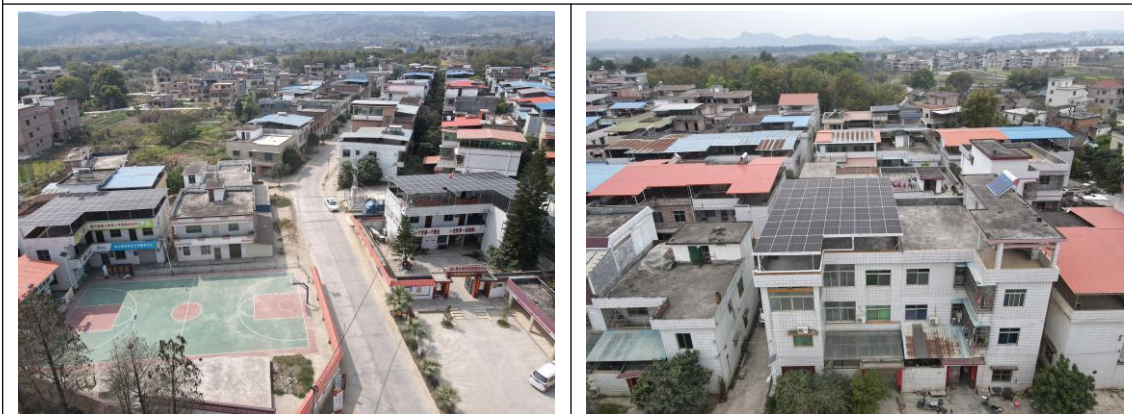
城南镇杨公岭村居民屋顶分布式光伏发电项目
