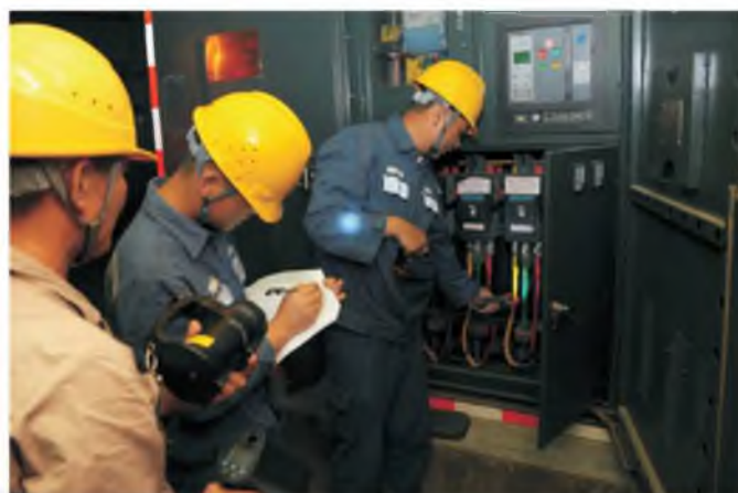
太平配电运维班开展夜巡
